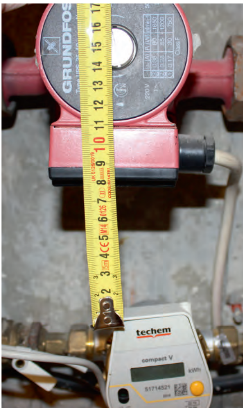
Fehlender Abstand zwischen Wärmehähler und Zirkulationspumpe führt zu Fehlmessungen und falschen Abrechnungen.
